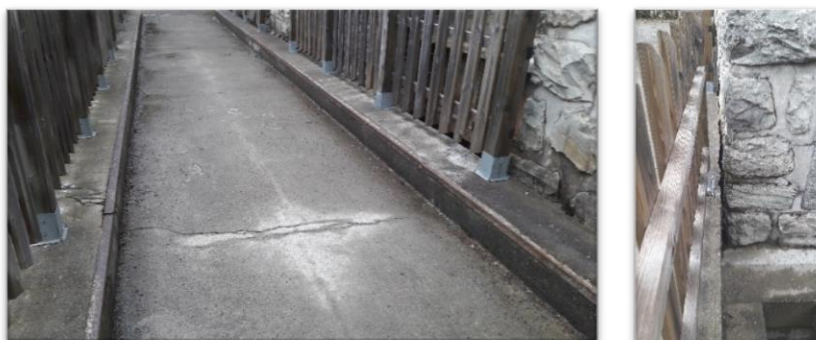
Figure 7 : rupture en flexion du pont au droit de la pile n°3 et décollement au droit de la pile n°2
