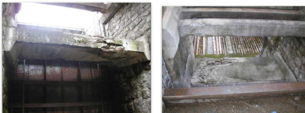
Figure 4 : Rupture en compression des boutons de la passe centrale
