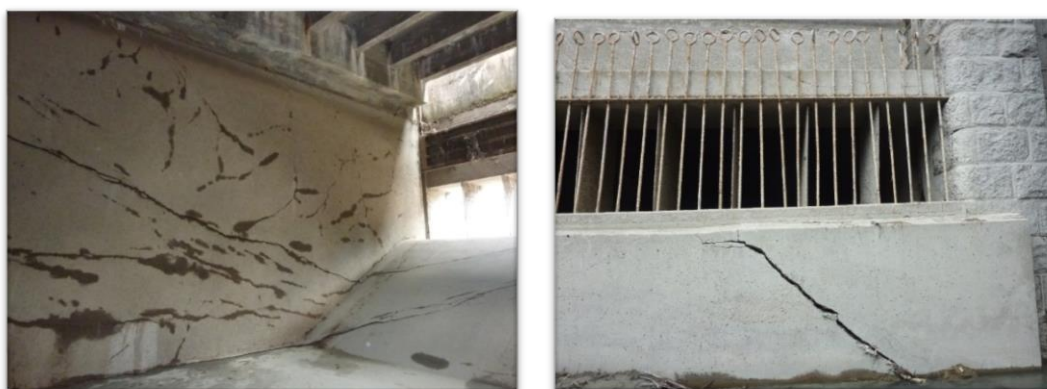
Figure 6 : Fissuration sur le seuil et le mur aval du bassin de décantation
