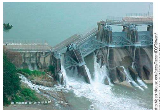
Figure 3 : rupture du barrage de Shih-Kang, photo tirée de [2]
