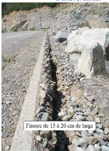
Figure 9 : photo de la fissuration longitudinale. Photo Geffraye - EDF
