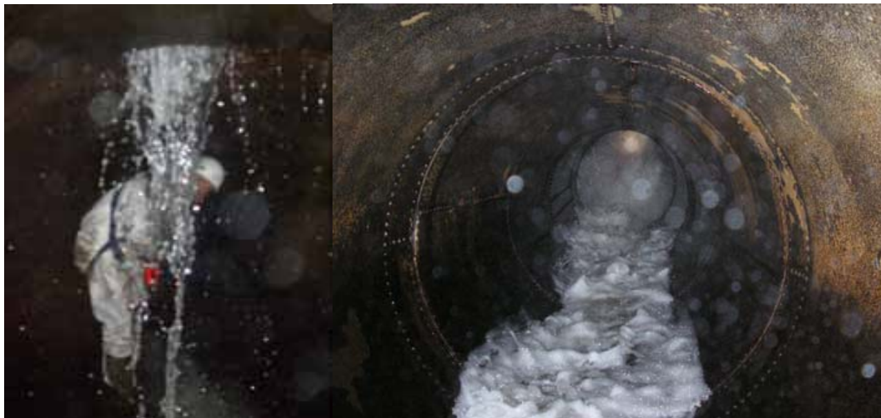
Graphique 4 : visite des parties d'ouvrages dans des conditions d'un barrage en charge. Les visites sont parfois difficiles à réaliser mais offrent l'avantage de visualiser de façon évidente les anomalies (photographie de gauche : fuites dans un reniflard de conduit de vidange de fond, photographie de droite : anomalie dans l'étanchéité d'une vanne papillon) .
