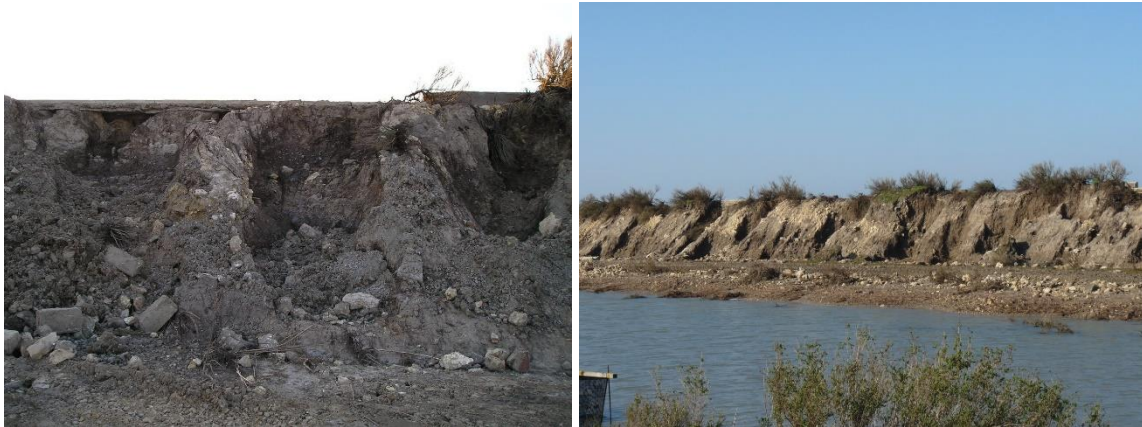
Figure 4 : érosion du talus aval (côté terre) lors de la tempête Xynthia dans la baie de Bourgneuf (85).
