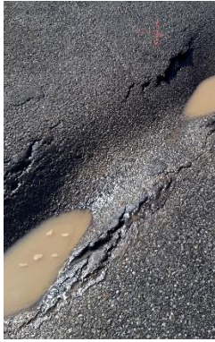
Figure 9 : affaissements et fissures constatés sur le masque amont © EDF
