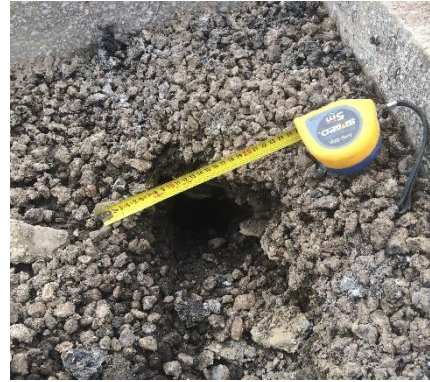
Figure 10 : conduit d'érosion formé dans le béton bitumineux drainant © EDF
