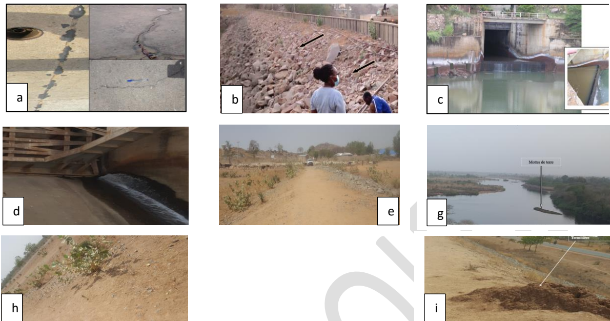
Figure 4 : Illustration des désordres observés sur les parties d'ouvrage. a) Fissures transversales de crête, b) Dégradation de talus avec ségrégation des enrochements, c) Détérioration du béton par efflorescence d) Fuite d'eau à travers les clapets de vanne, e) Point bas sur la crête et érosion anthropique, g) Sédimentation retenue aval, h) Développement de la végétation et dégradation du talus, i) Termitières
