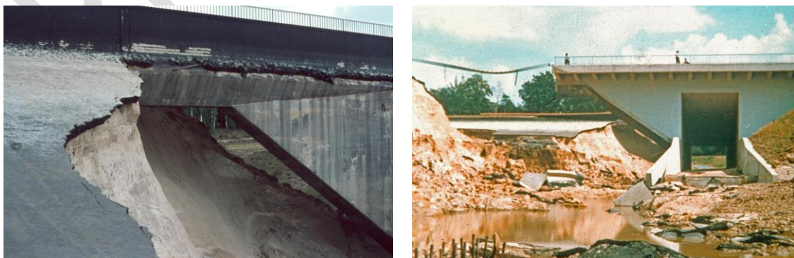
Figure 6 : Erosion interne au niveau de la transition remblai/structure GC de l'ouvrage traversant
