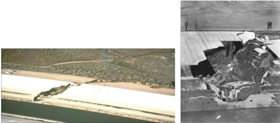
Figure 3 : Brèche du canal Lower Quail
