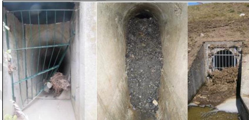
Figure 7 - Embâcles et transport solide dans les ovoïdes
