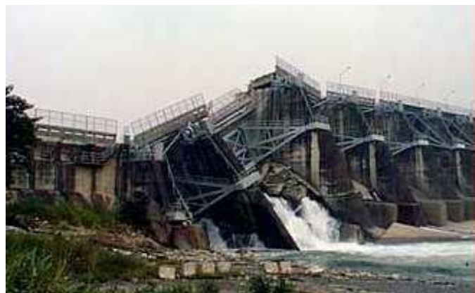
Figure 8 : Agression sismique - Barrage de Shih-Kang (Taïwan) - Séisme du 21 septembre 1999
