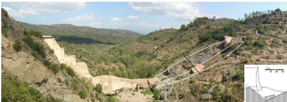
Figure 5 : Exemple de défaillance structurelle – Ruine du barrage de Malpasset
