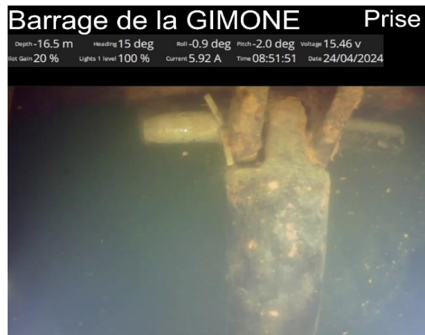
Figure 5 : Raccordement de la brimbale de la vanne batardeau sur son support
