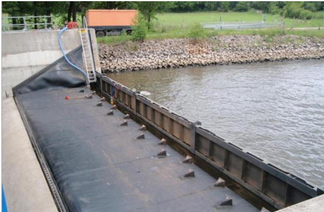
Figure 7 : mise à sec d'une passe pour inspection de la membrane, barrage de Bannetze, Allemagne, © BAW
