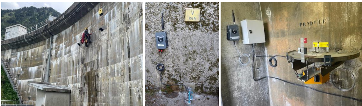
Figure 10 : Instrumentation temporaire avec capteurs IoT, pour suivi d'une période de travaux
