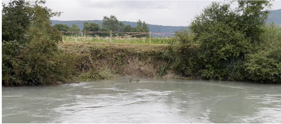
Figure 4 : Exemple de désordre observé
