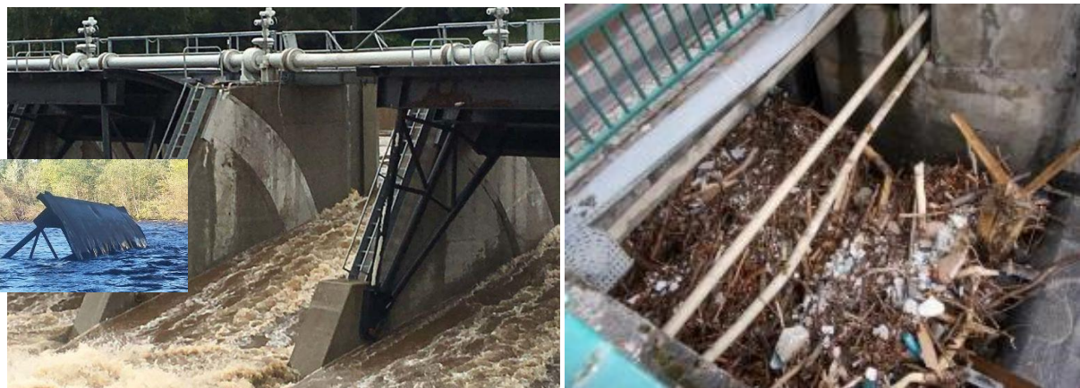
Figure 14 : a) Rupture d'une vanne segment au barrage de Black River (USA, 2016), Déformation d'un arbre de synchronisation lors d'une crue (France, 2013)
