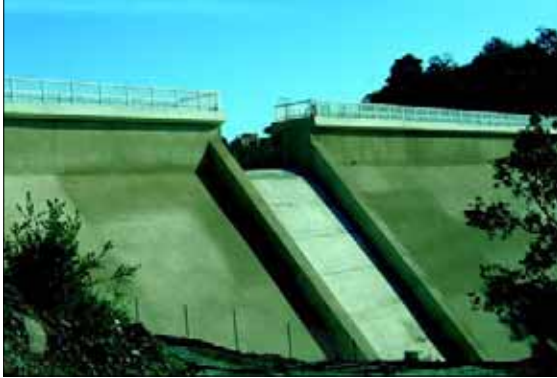
◀ 21 - Barrage poids en béton (texte p. 116).
