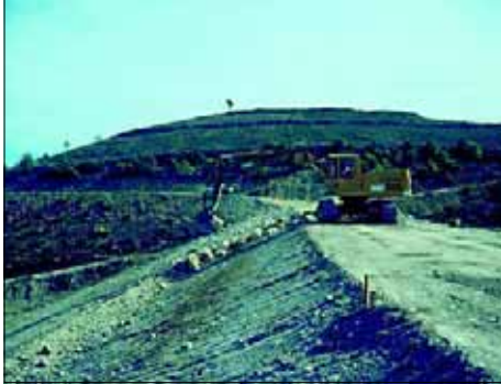
◀ 11 - Mise en place d'un revêtement antibatillage en partie supérieure d'un barrage à plan d'eau constant (texte p. 76).
