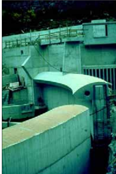
22 - Barrage voûte à simple courbure (prise d'eau du Chapeauroux). On notera la partie déversante en forme de Creager (texte p. 115).
