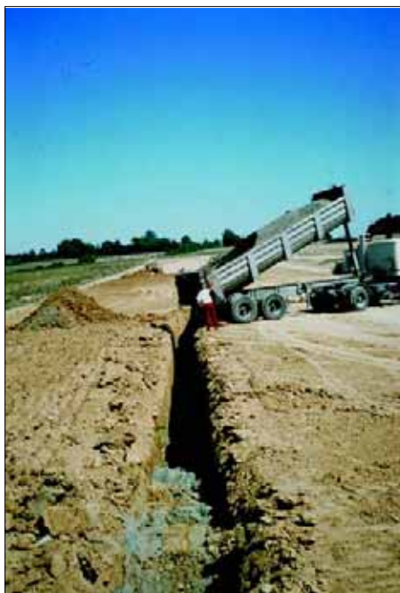
◀ 2 - Drain vertical creusé dans le remblai et remplissage par du sable drainant et autofiltrant (texte p. 78).
