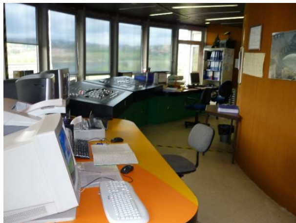
Salle de commande
