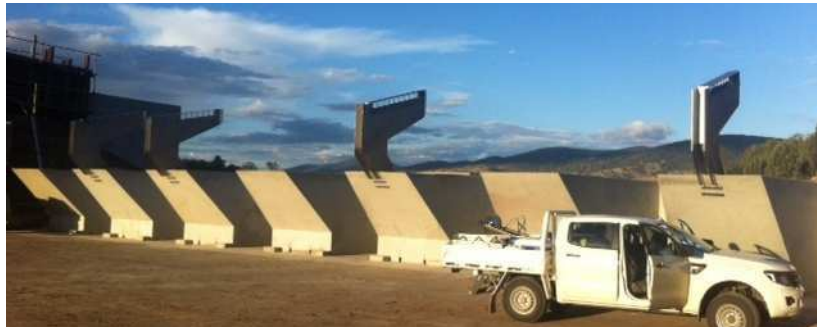
Fig. 6 Fusegates® installées – Barrage de Quipolly
