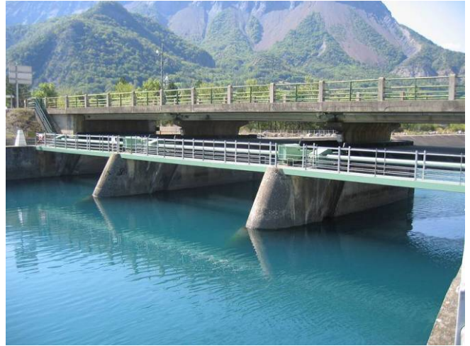
Vannes d'entrée canal ouvertes, vues de la retenue d'Espinasse en amont du canal
