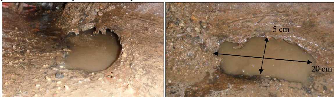
Graphique 4 : Trou en radier dans la partie aval de la conduite
